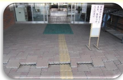
地震により段差ができた 新習志野図書館正面玄関（平成23年3月撮影）
